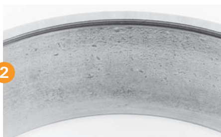
Escoriações Fragmentos de metal de outros componentes, vedação inadequada e manutenção deficiente.
